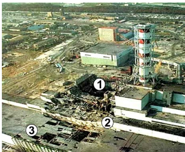
Рис. 1. Разрушения, вызванные аварией:
